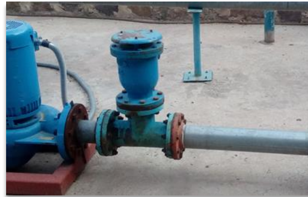
Válvulas de admisión y expulsión de aire en puntos críticos
