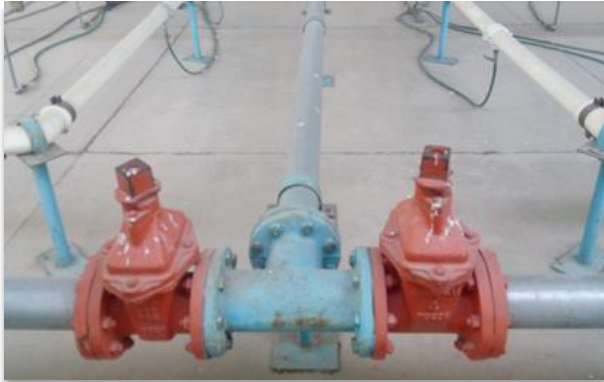
Válvulas de seccionamiento *
