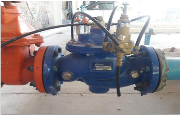
Válvulas de control, para mejorar las condiciones de operación *
