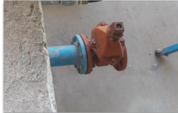
Válvulas de desfogue en puntos bajos
